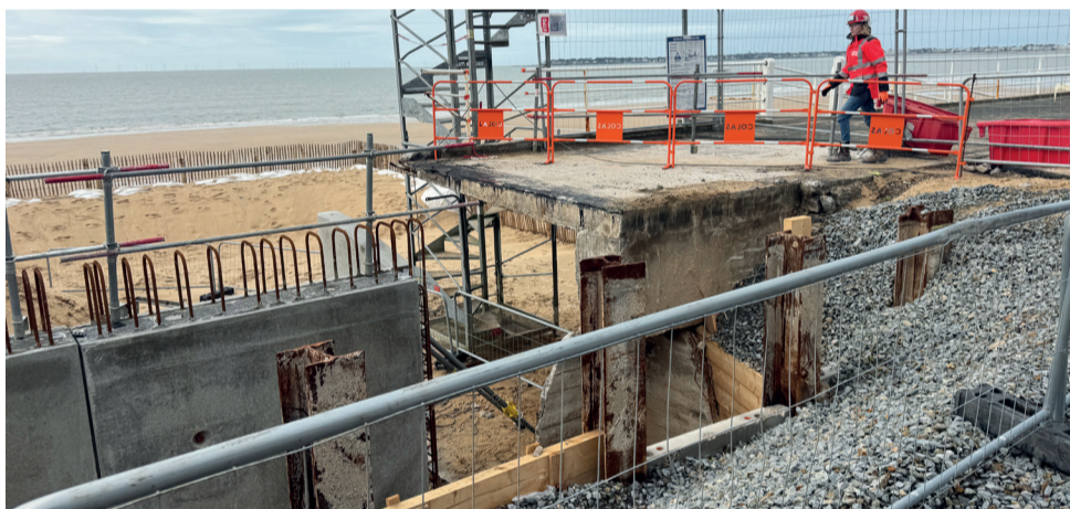
Un encorbellement surplombe la plage et le mur de protection, comme si un balcon de 4 mètres, avec 12 centimètres d'épaisseur, était posé sur le mur historique.
